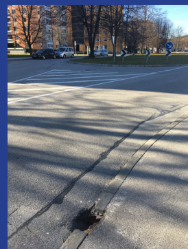
Poškodovan robnik pločnika na Cesti talcev
